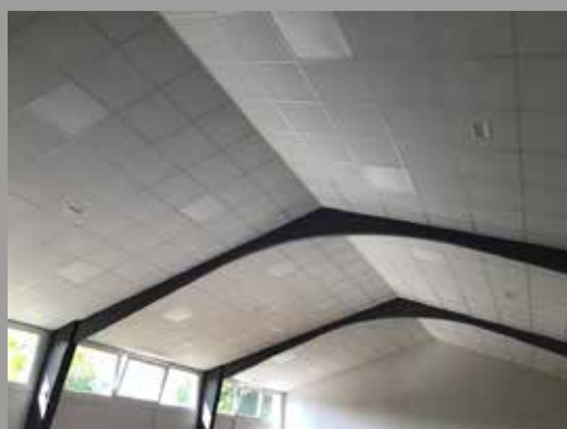
Nouvel éclairage LED
