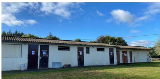
Sanitaires camping avant travaux
